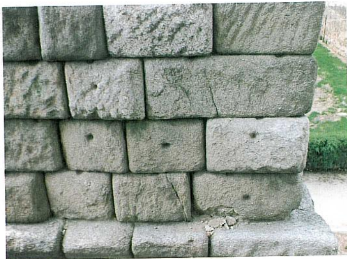
Pila con sillares aparentemente sanos en su textura superficial (aún conservan el tratamiento original de sus caras mediante escafilado y las hendiduras para que la gafa o tenazas metálicas usadas en el izado de las piedras pudiera agarrar el sillar). Sin embargo aparecen fisuras y desmoronamientos importantes. (Fotografía original de 19x12,5 cm. del propio autor).
