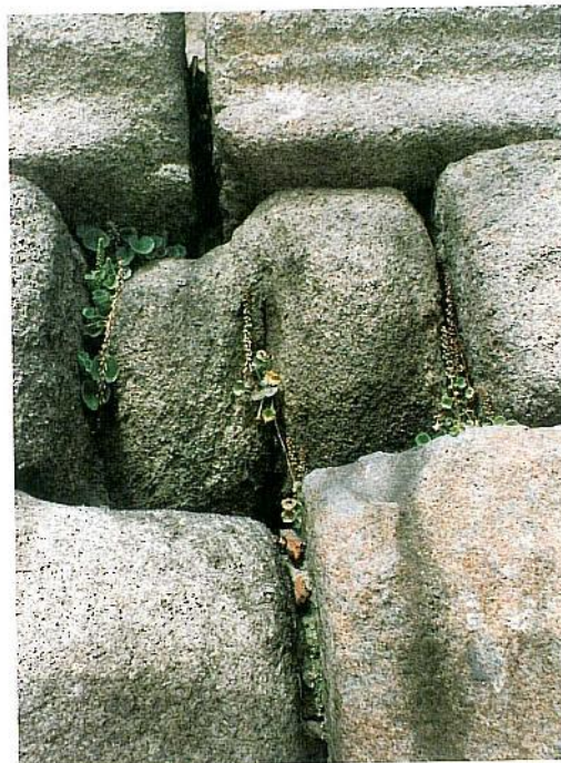
Los elementos vegetales también juegan su papel en el deterioro arrajgando en el material delezonado depositado en las juntas. (Fotografía original de 19x12,5 cm. del propio autor).
